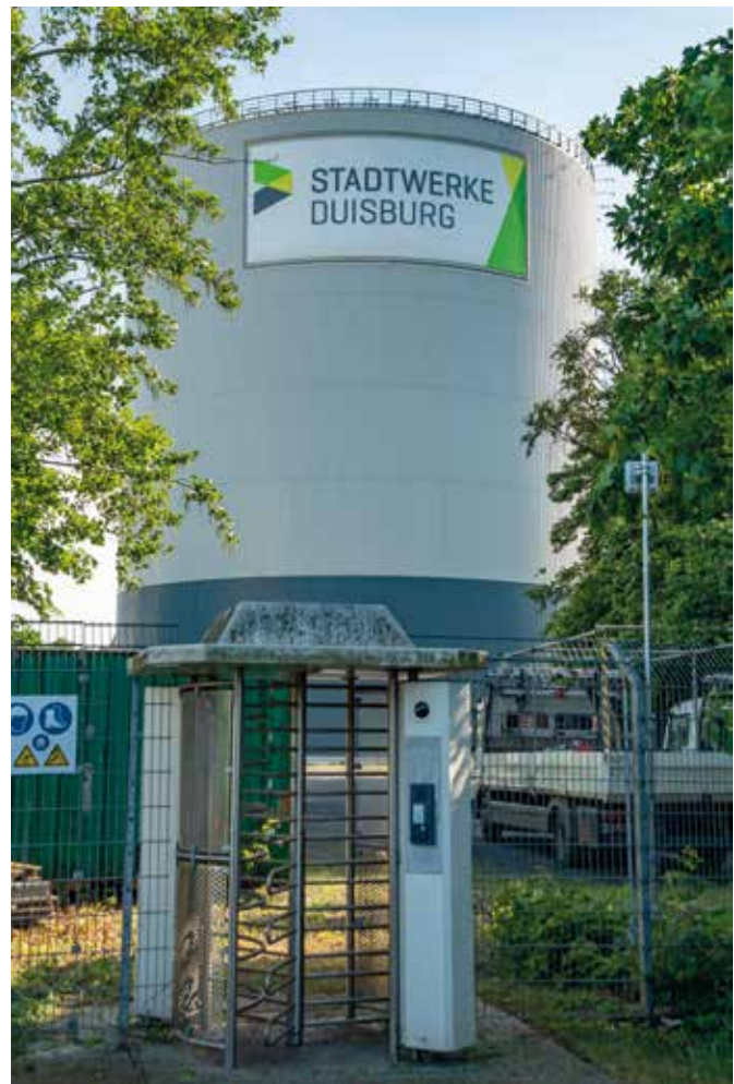
Im Jahr 2018 bauten die Stadtwerke in Wanheim einen großen Wärme-Wasser-Speicher, um immer genügend Reserve in den Fernwärmenetzen zu haben.
